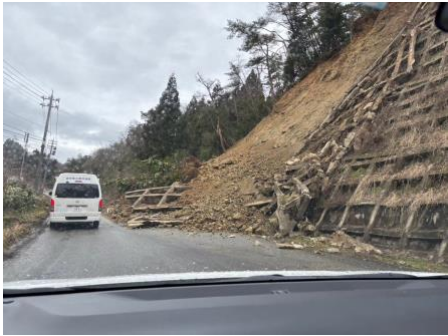
(土砂崩れのため一方通行となっている)
