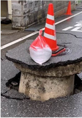
道路から突出したマンホール
